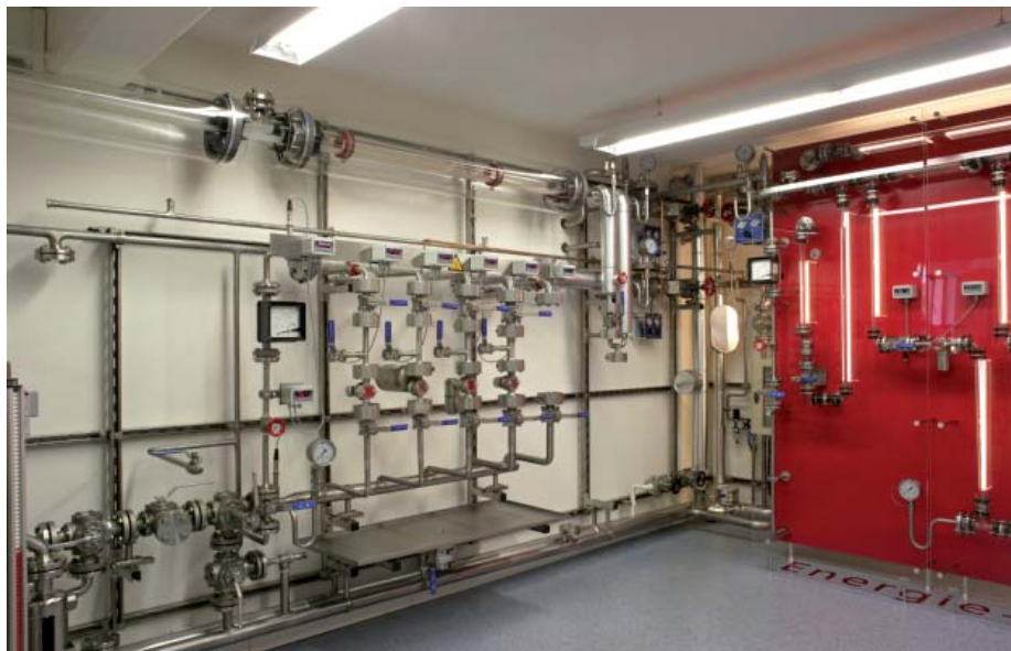
Abb. 1: Schulungscenter der Franz Gysi AG, Dampfanlage
