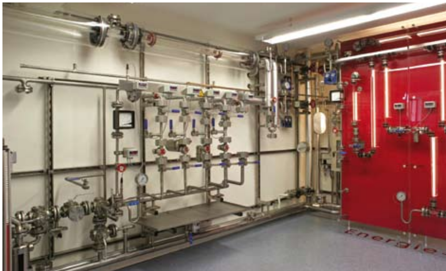
Schulungszentrum der Franz Gysi AG – Dampfpanlage mit QVF® Glasrohren
