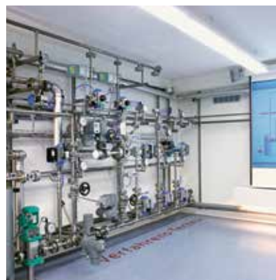
Centre de formation technique des procédés/automatisme
